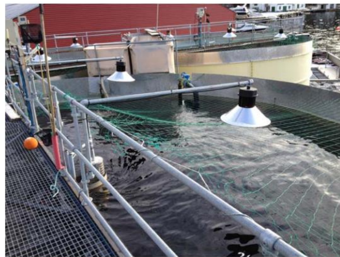
LED High Bay i oppdrettsanlegg for laks
