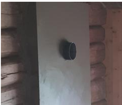
Brannsikring rundt røykrør på Ulsrudsetra. Foto:khr
