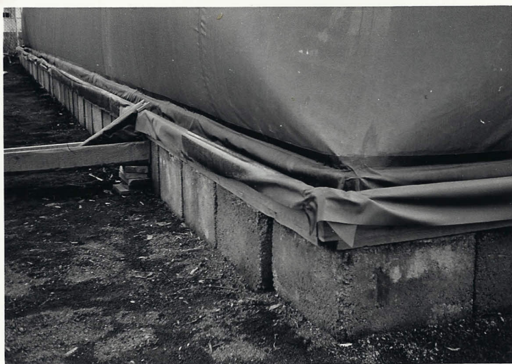
FORANKRINGEN PÅMONTERT TAKRENNE
